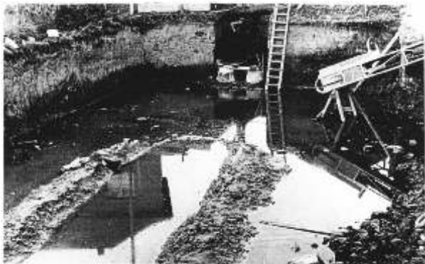
Abb.40 Unerwarteter Wassereinbruch in der Baugrube des 2. Bauabschnitts. Aufnahme wahrscheinlich Willi Mock. Foto Archiv Töpfermuseum.
